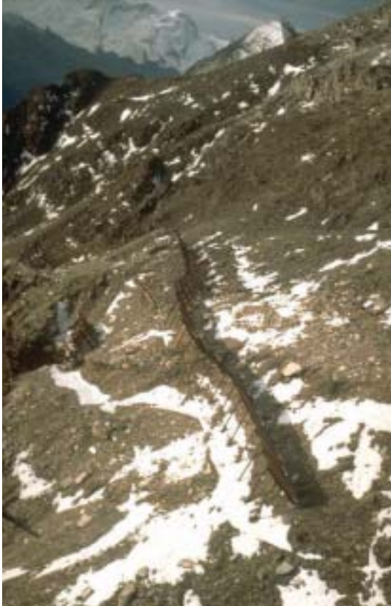
Abb. 8: Lawinerverbauungen bei Wisse Schijen oberhalb von Randa im Mättertal (CH). Die Deformation der Strukturen durch die Kriechbewegungen des Hanges sind deutlich sichtbar: ca. 1,5 m in 5 Jahren. Die Verbauungen wurden unterdessen entfernt und an anderer Stelle neu aufgestellt. Foto: Stefan Margreth (SLF).
